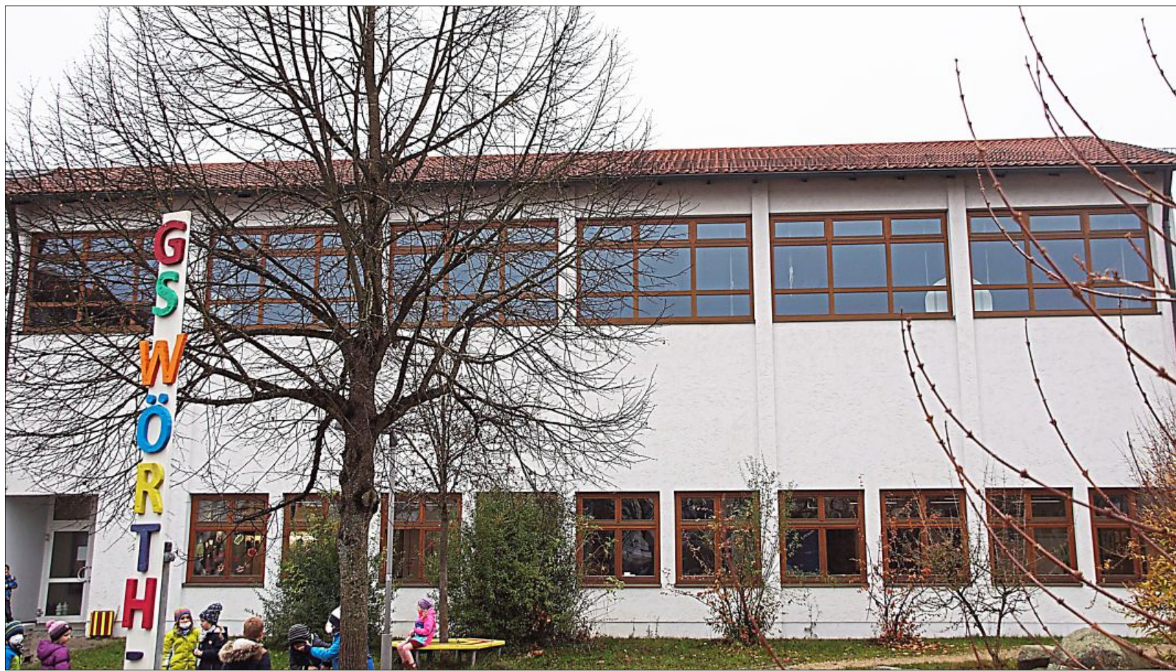
Die Lüftungsanlage der Schulturnhalle (erster Stock) ist in die Jahre gekommen. Im Frühling 2022 will die Gemeinde aktiv werden.
