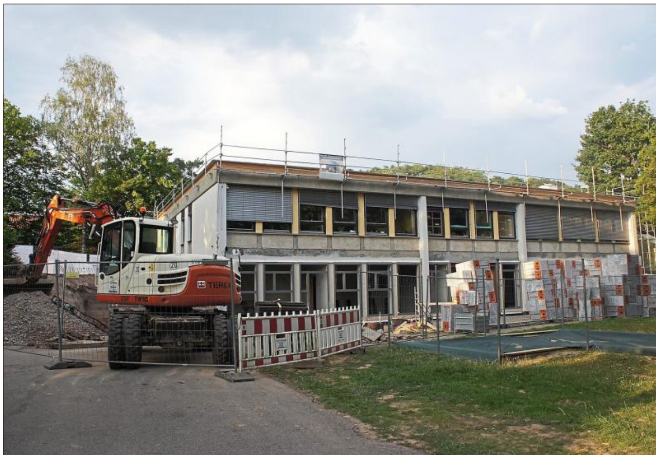
Äußerst gut im Zeitplan liegt die Sanierung des Kinderhauses. Der Gemeinderat informierte sich.
